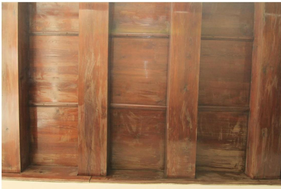
FOT. 19 - IV kondygnacja – strop nad korytarzem i klatką schodową.
