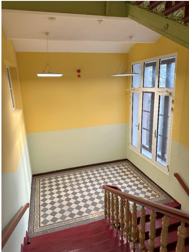
Fot. 13 Klatka schodowa narożna (K2) –I piętro, stan istn.
