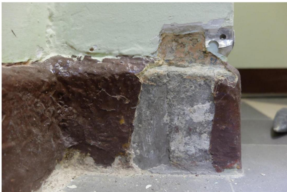
FOT. 9 - Klatka schodowa narożna, parter – odstąpiły fragment ceramicznej płytki cokołowej
