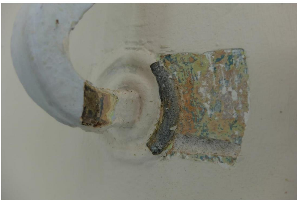
FOT. 4 – detal. fot. 2 – ściana policzkowa schodów- odkrywki na tynku ściany i stalowym wsporniku balustrady schodów.
