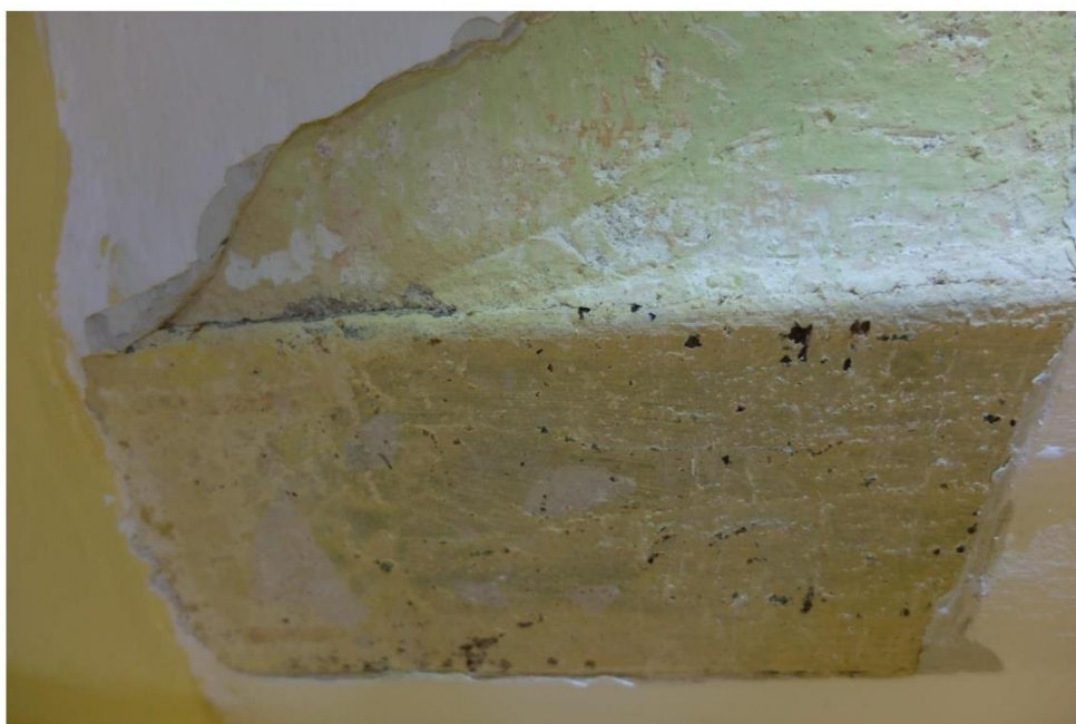
FOT. 22 – Klatka schodowa narożna, parter strop parteru fragment – belka stalowa i tynk. ←
