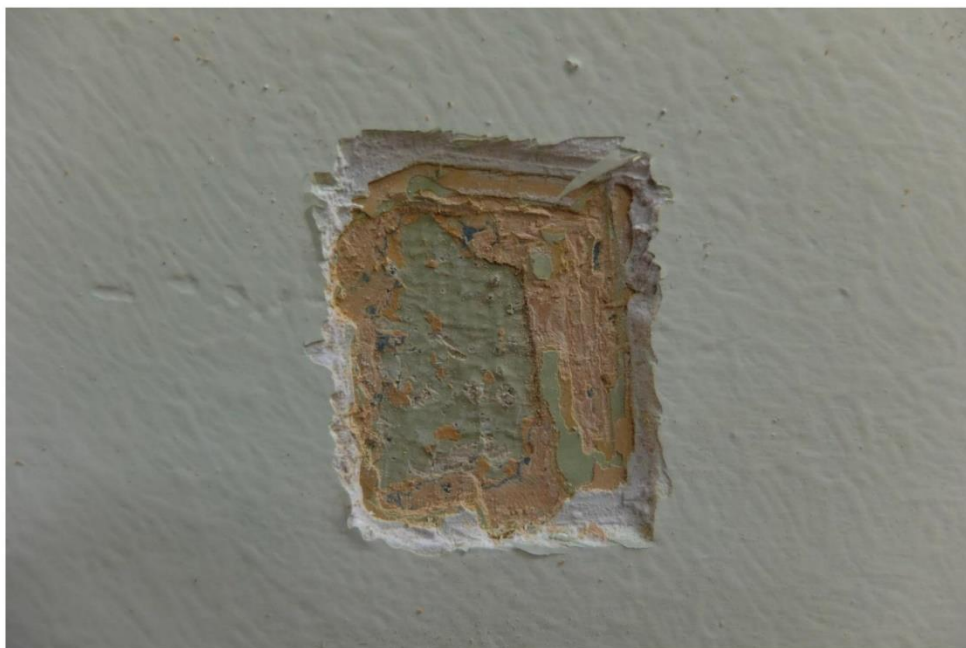
FOT. 21- detal fot. 19 – lamperia, odstąpiona powłoka malarska I fazy chronologicznej.
