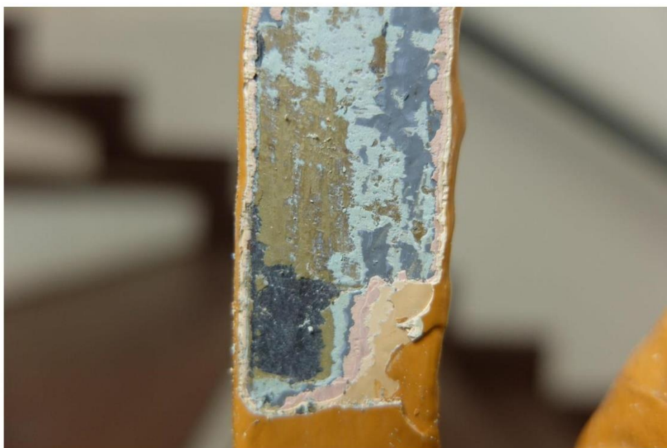
FOT. 7, 8 - detal fot. 2 – balustrada schodów, fragment, miejsca odkrywek, odstąpiła powłoka farby wystroju pierwotnego.
