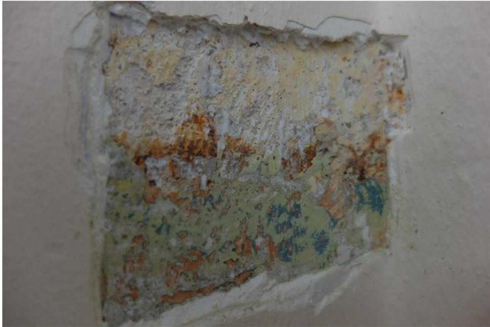
FOT. 5 – detal fot. 2 – ściana południowa , odkrywka na poziomie zakończenia oryginalnego pasa lamperii ściany.
