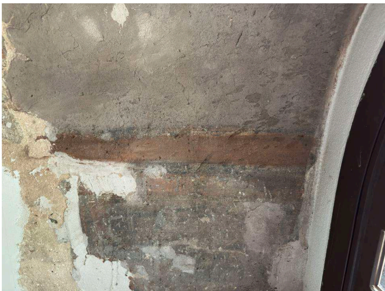
Fot. 10. Oryginalna opaska przed pracami rekonstrukcyjnymi, z widocznymi opaskami zabezpieczającymi 13
