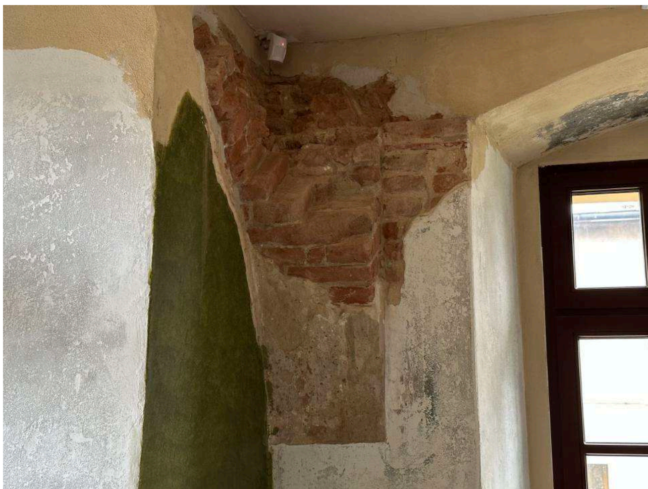
Fot. 16. Relikt sklepienia B - stan obecny, po niewłaściwym "zaszpachlowaniu" i zamalowaniu reliktyw malatur
