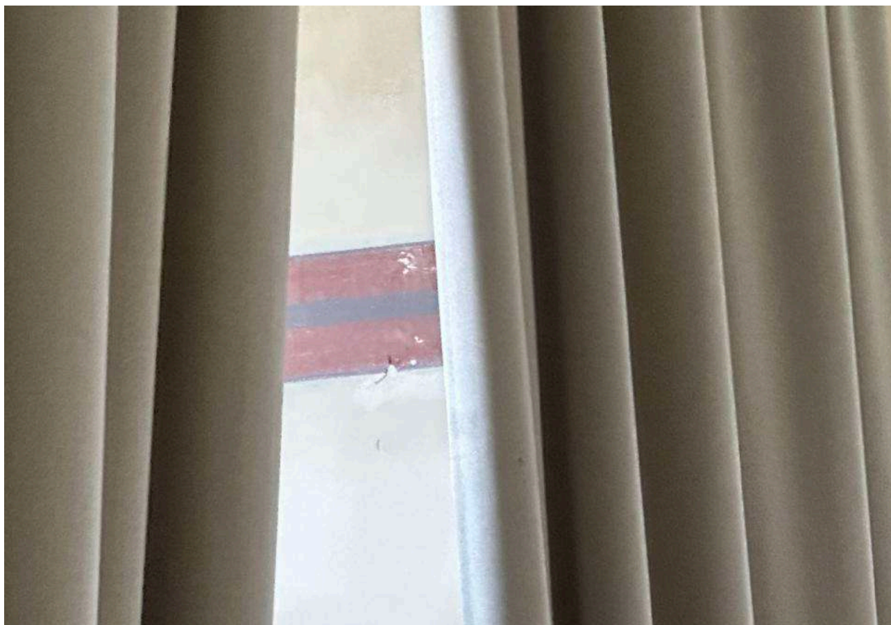
Fot. 14. Jedna z opasek - stan po oczyszczeniu z zamalowania i nieudolnych próbach rekonstrukcji, widok obecny
