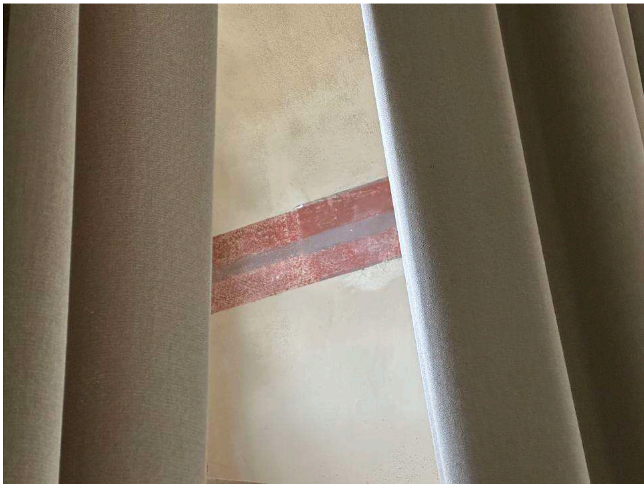
Fot. 13. Jedna z opasek - stan po oczyszczeniu z zamalowania i nieudolnych próbach rekonstrukcji, widok obecny
