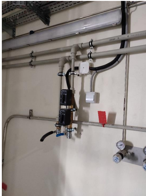
Zdjęcie 2. Przyłącze instalacji wody c chłodzącej przy stanowisku
