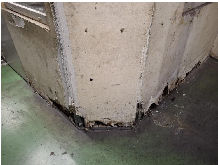
Zdjęcie przykładowego odcinka zabudowy GK do naprawy
